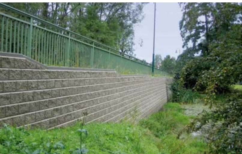
Stützwand Ortsdurchfahrt Burkau Deutschland | Straßensanierung einschließlich Dammschüttung – Optimale Platzausnutzung – Stützwand unmittelbar an einem Teich – Ausführung mit resistenten Beton-Hohlkammersteinen – Wandneigung von 84°.
