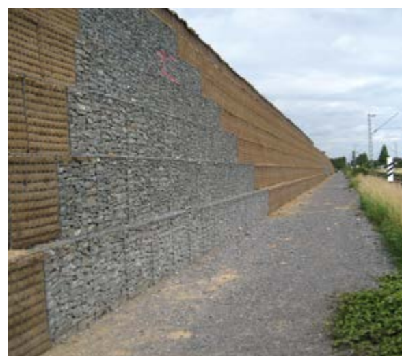
Lärmschutzwand für ein Wohngebiet in Neuss Deutschland | Bebauungsgebiet an Bahnstrecke und Kreisstraße – Kombination Vollgabionenwand zu Gleisen, Naturböschung zur Wohnbebauung – Befüllung der Gabionen mit Steinen, aber auch mit Erde + Bepflanzung – Höhe 10 m und 68^\circ gleisseitiger Neigungswinkel.
