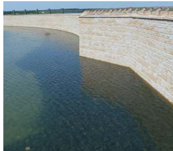
Kaianlage am neuen Störnthaler See Deutschland | Renaturierung des ehemaligen Tagebaurestlochs Espenhain – Moderne Architektur – Resistente Beton-Hohlkammersteine und Fortrac Geogitter aus PVA stellen die Dauerbeständigkeit der neuen Kaianlage bei stark sulfathaltigem Flutungswasser sicher.
