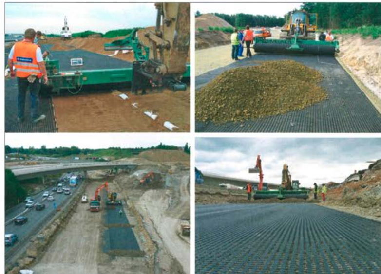
13 BAB A57 bei Asdonkshof (beide Fotos oben) und BAB A4, Westkreuz Bochum (beide Fotos unten): Präzise Verlegung der Geogitter unter konstruktiver Vorspannung/Strammung Quelle: HUESKER
