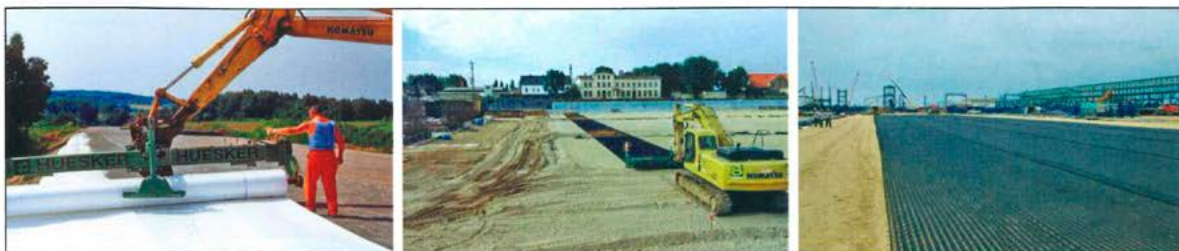
8 Vorrichtung und Technik zur strammen Verlegung von Geobewehrungen, korrekt verlegtes Geogitter (v.l.n.r.)
