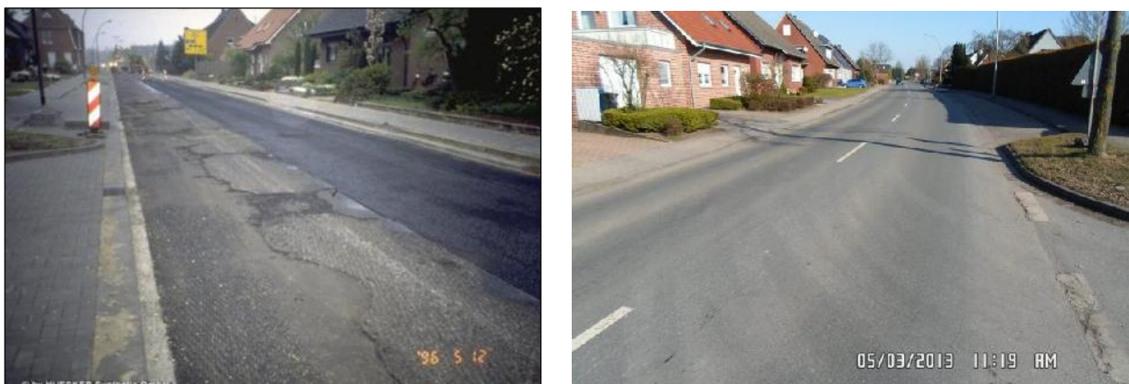
Figure 9 : Etat de la chaussée à Ochtrup (Allemagne) avant réhabilitation en 1996 (à gauche) et en 2013 (à droite)
